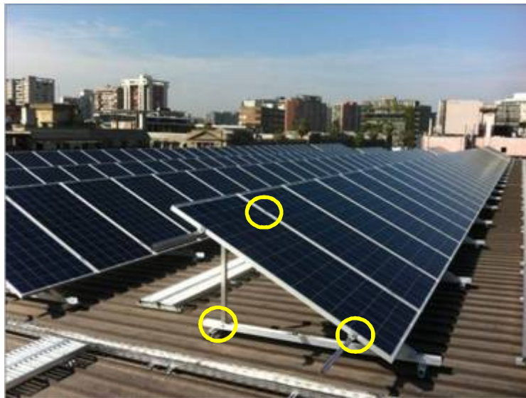
Ilustración 3. Fotografía proyecto GAM Santiago. En amarillo las grapas finales e intermedias solidarias a la estructura de soporte, la que a su vez se fija a las costaneras de la techumbre del edificio
