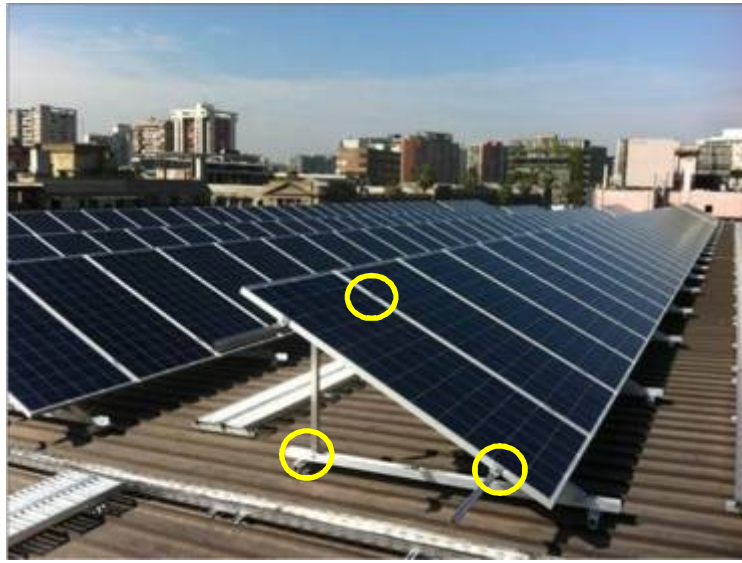
Ilustración 4. Fotografía proyecto GAM Santiago. En amarillo las grapas finales e intermedias solidarias a la estructura de soporte, la que a su vez se fija a las costaneras de la techumbre del edificio
