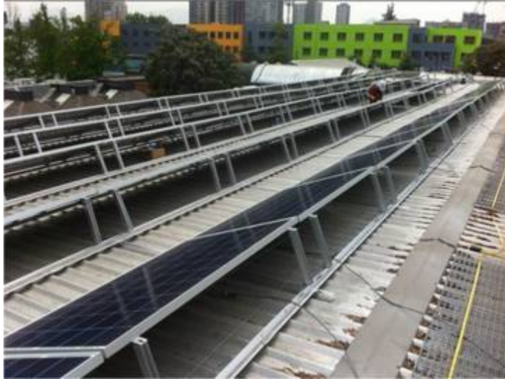
Ilustración 1. Estructura de anclaje típica para módulos fotovoltaicos inclinados sobre cubierta. Foto proyecto Teletón Santiago, Programa Techos Solares Públicos
