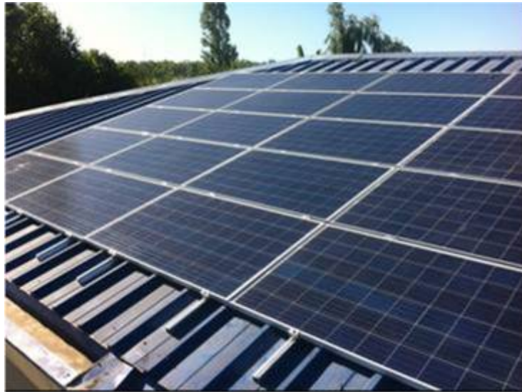
Ilustración – Estructura de anclaje Típica para módulos fotovoltaicos paralela a cubierta. Foto proyecto Juzgado Garantía de Parral, Programa Techos Solares Públicos
