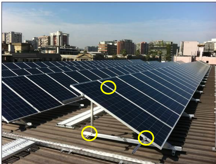
Ilustración 3. Fotografía proyecto GAM Santiago. En amarillo las grapas finales e intermedias solidarias a la estructura de soporte, la que a su vez se fija a las costaneras de la techumbre del edificio
