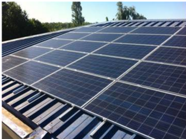
Ilustración – Estructura de anclaje Típica para módulos fotovoltaicos paralela a cubierta. Foto proyecto Juzgado Garantía de Parral, Programa Techos Solares Públicos
