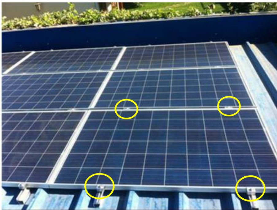
Fotografía proyecto Juzgado de Garantía Parral. En amarillo las grapas finales e intermedias solidarias a la estructura de soporte, la que a su vez se fija a las costaneras de la techumbre del edificio.
