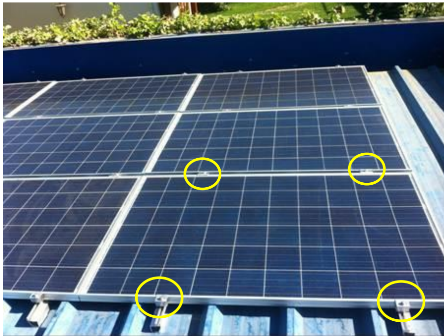
Fotografía proyecto Juzgado de Garantía Parral. En amarillo las grapas finales e intermedias solidarias a la estructura de soporte, la que a su vez se fija a las costaneras de la techumbre del edificio.
