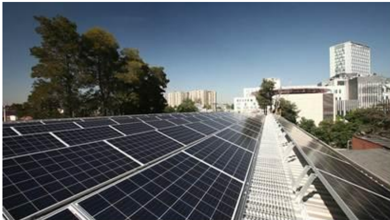
Ilustración - Módulo fotovoltaico tipo, potencia de 250 W, dimensión de 1,6 m x 1 m. Peso aproximado 15 kg. Foto proyecto Teletón Santiago, Programa Techos Solares Públicos.
