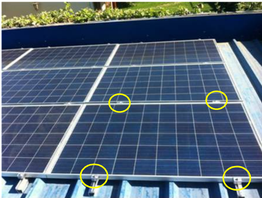
Fotografía proyecto Juzgado de Garantía Parral. En amarillo las grapas finales e intermedias solidarias a la estructura de soporte, la que a su vez se fija a las costaneras de la techumbre del edificio.
