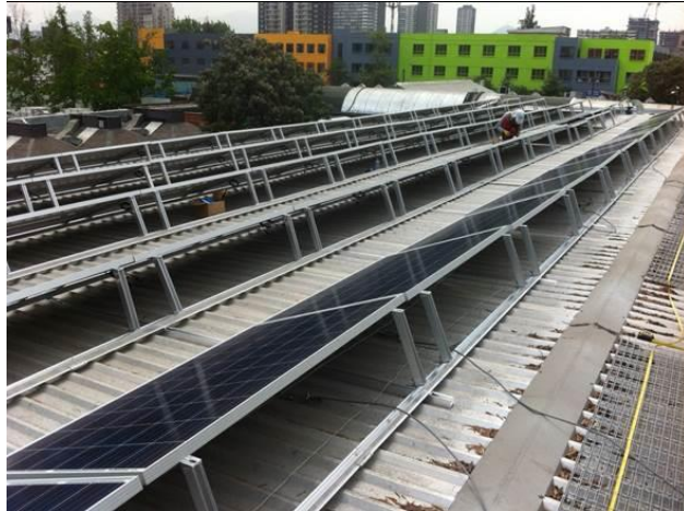
Ilustración. Estructura de anclaje típica para módulos fotovoltaicos inclinados sobre cubierta. Foto proyecto Teletón Santiago, Programa Techos Solares Públicos
