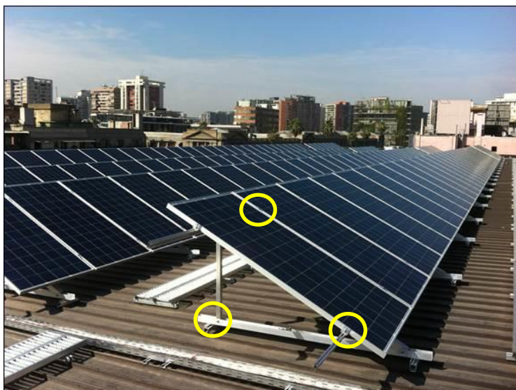
Ilustración 4. Fotografía proyecto GAM Santiago. En amarillo las grapas finales e intermedias solidarias a la estructura de soporte, la que a su vez se fija a las costaneras de la techumbre del edificio
