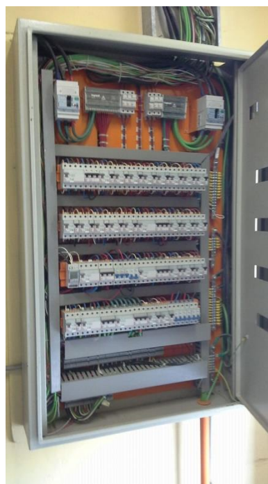
Ilustración 13. Cuadro eléctrico generador.
