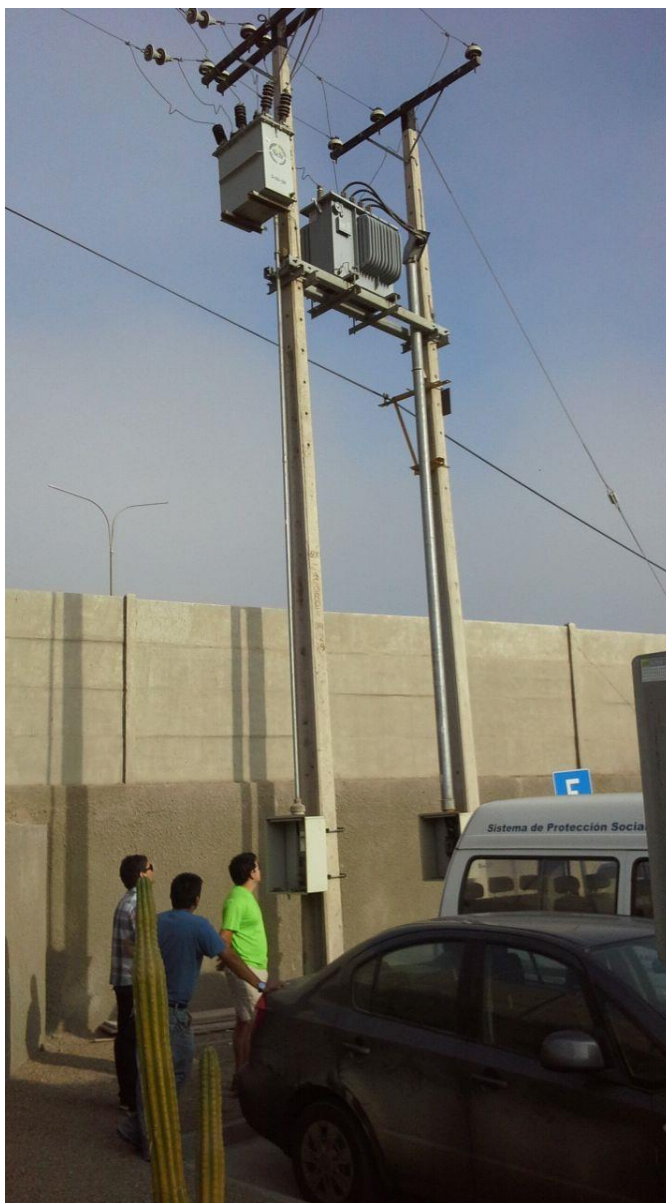
Ilustración 12. Ubicación de empalme y medidor.
