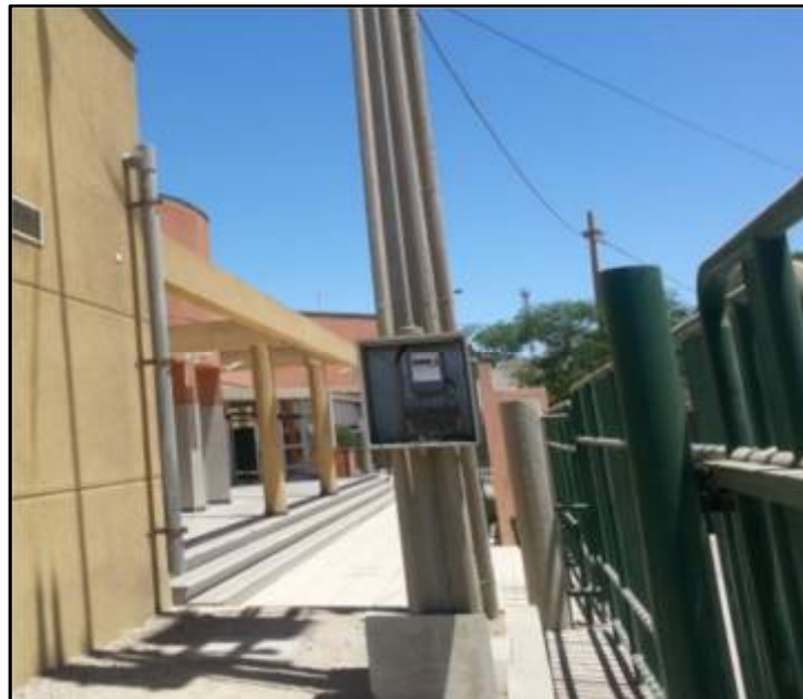
Ilustración 16 Ubicación de medidor eléctrico.
