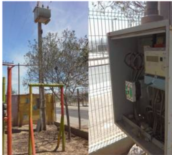
Imagen 19: detalle de conexión general (punto de Conexión SFV)
