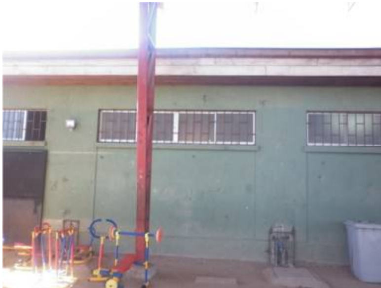
Ilustración 14: muro ubicación del inversor.
