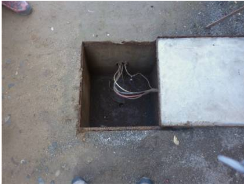
Ilustración 15: cámara de registro eléctrica, junto a medidor.
