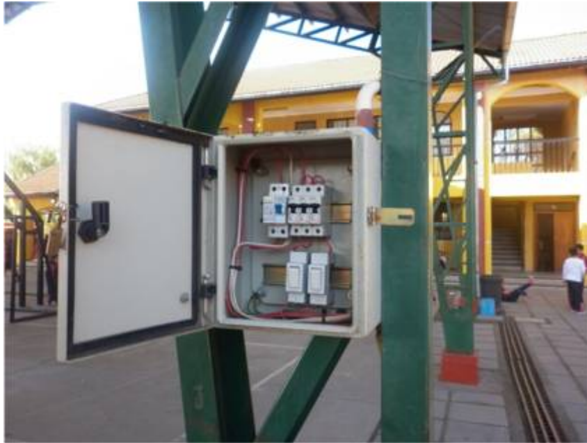
Ilustración 13: detalle tablero iluminación multicancha.
