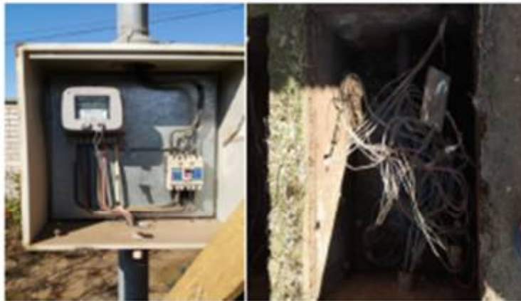
Instalaciones y observaciones de Instalación eléctrica de Escuela Pehuenche
