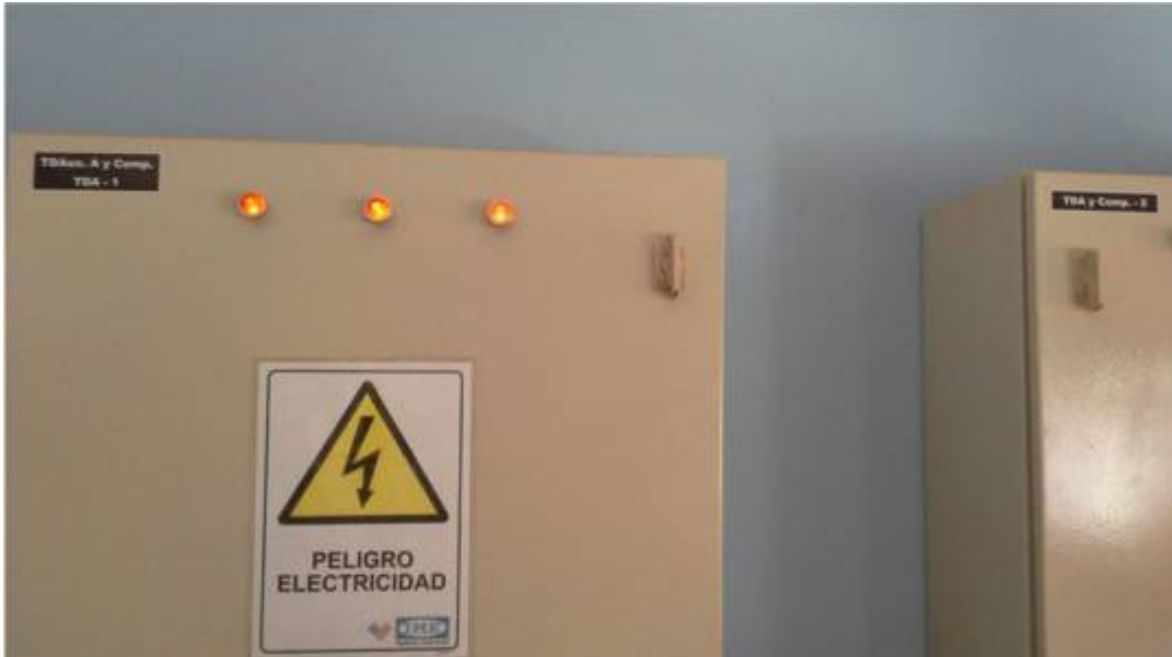
Ilustración 6: tablero eléctrico de conexión.
