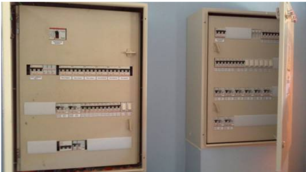
Ilustración 7: interior tablero de conexión.
