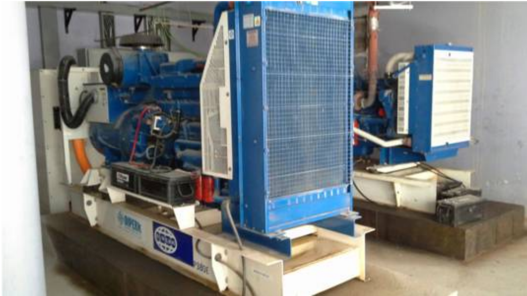
Ilustración 13: detalle del grupo generador.
