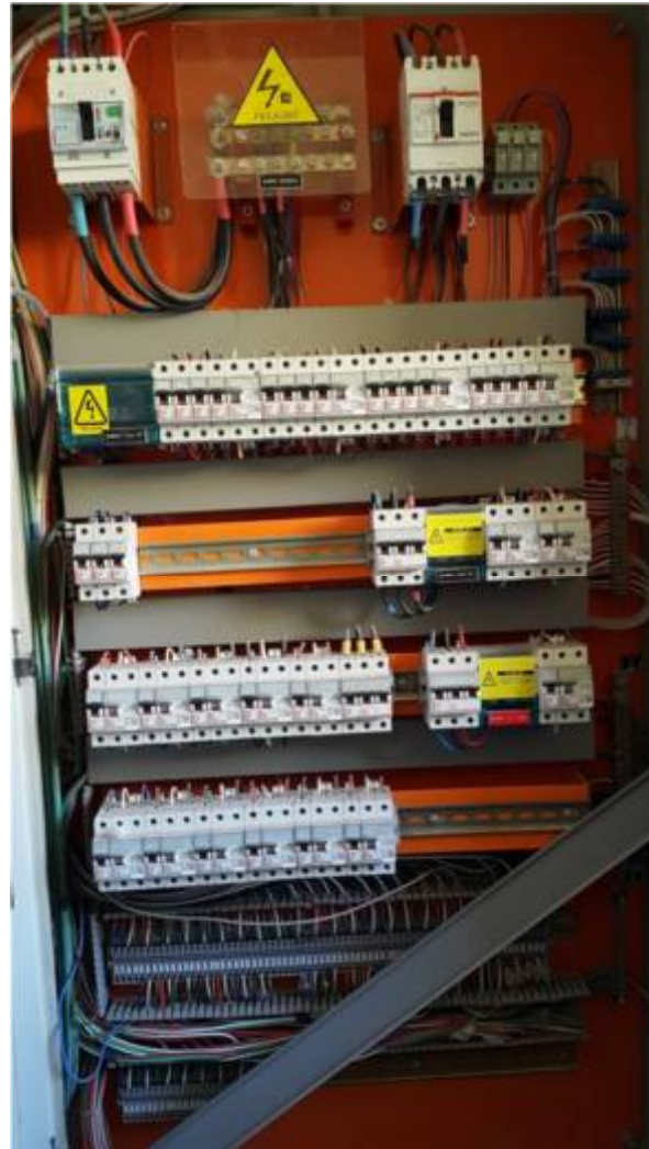
Ilustración 12: tablero TDA F Comp. y Policlínico F, punto de conexión.
