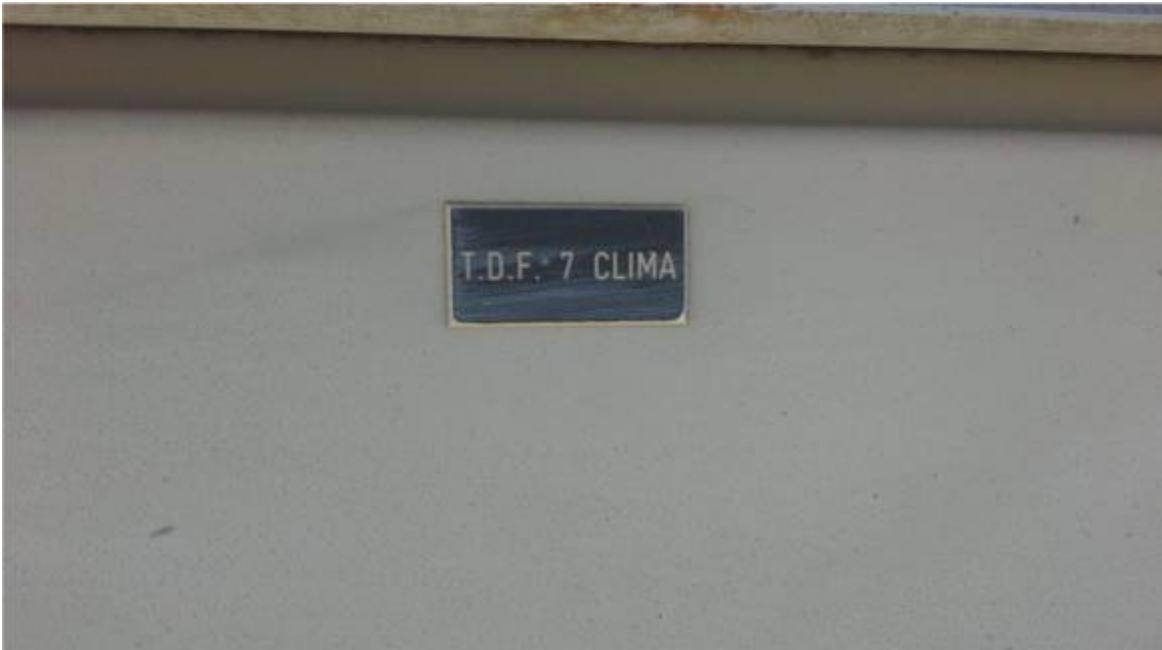
Ilustración 15: tablero de conexión.
