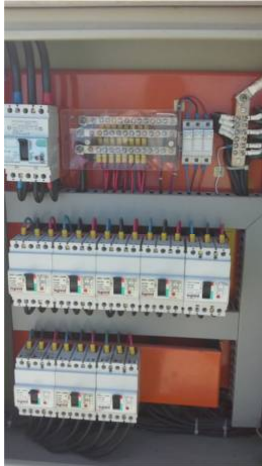
Ilustración 16: detalle del tablero de conexión.
