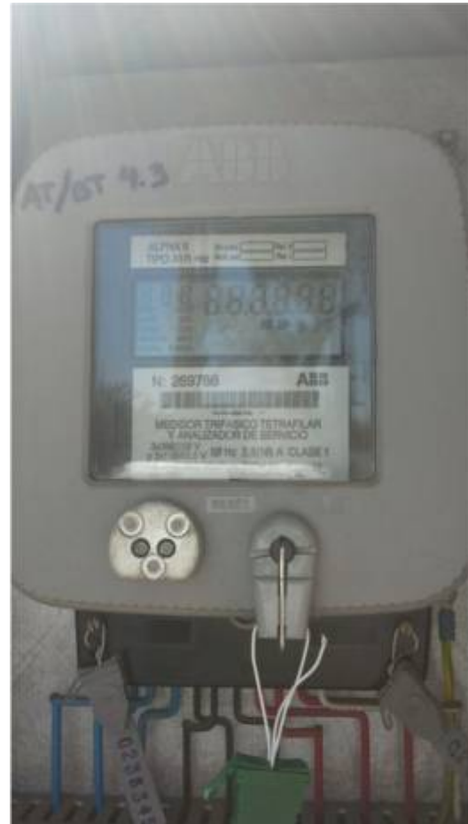
Ilustración 18: detalle de medidor.
