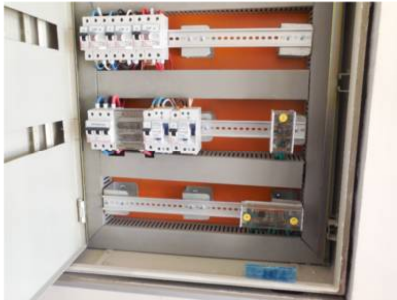
Ilustración 19: detalle interno del tablero.
