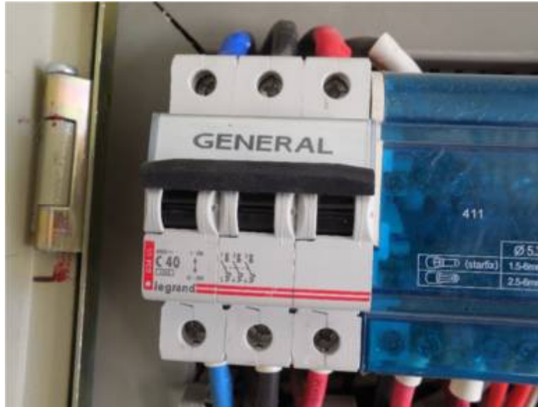
Ilustración 18: detalle protecciones de tablero.
