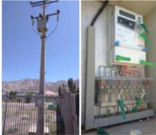
Ilustración 13: medidor, punto de conexión.
