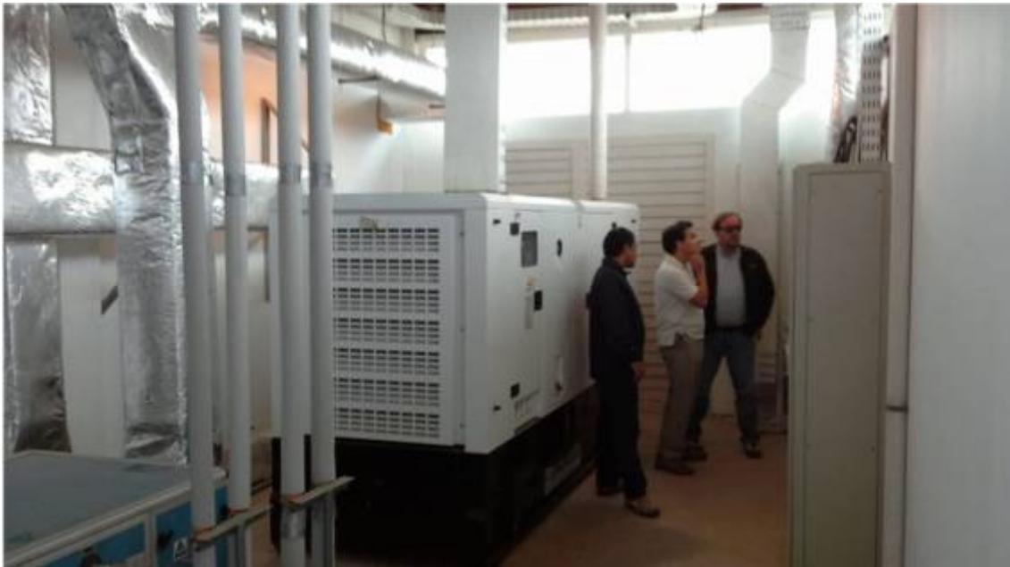
Ilustración 14: detalle del grupo generador.
