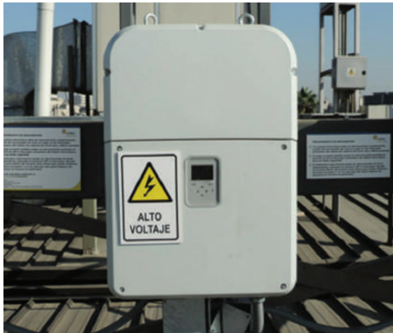
Ilustración 3 Inversor de 33 kW (Fuente: Ministerio de Energía)
