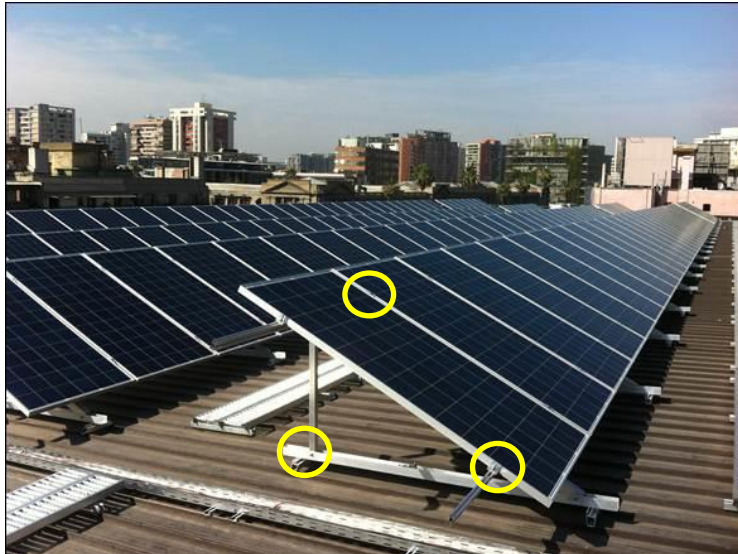
Ilustración 3. Fotografía proyecto GAM Santiago. En amarillo las grapas finales e intermedias solidarias a la estructura de soporte, la que a su vez se fija a las costaneras de la techumbre del edificio
