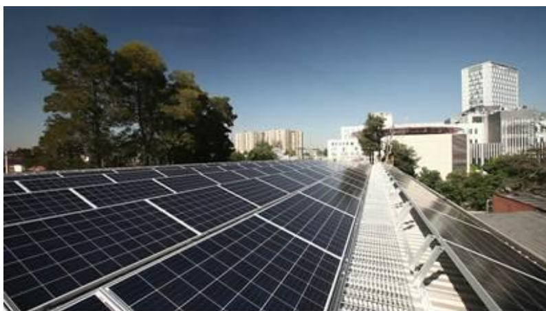
Ilustración 8 - Módulo fotovoltaico tipo, potencia de 250 W, dimensión de 1,6m x 1m. Peso aproximado 156 Kg. foto Proyecto Teletón Santiago, Programa Techos solares Públicos.
