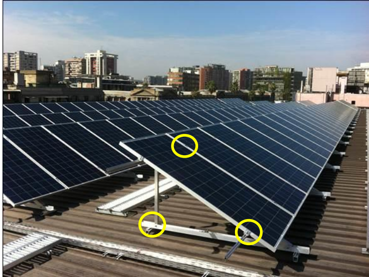
Ilustración 13 - fotografía proyecto GAM Santiago. En amarillo las grapas finales e intermedia solidarias a la estructura de soporte, la que a su vez se fija a las costaneras de la techumbre del edificio
