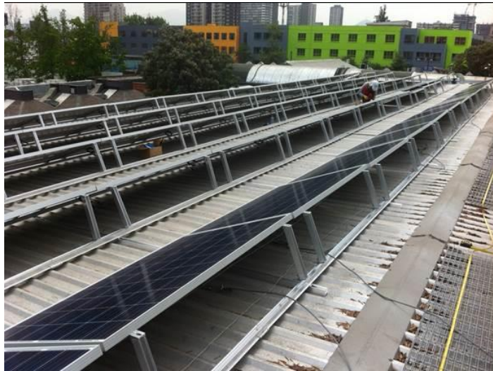
Ilustración 10 - Estructura de anclaje típico para módulos fotovoltaicos inclinados sobre cubierta. Foto proyecto Teletón Santiago, Programa Techos solares Públicos.
